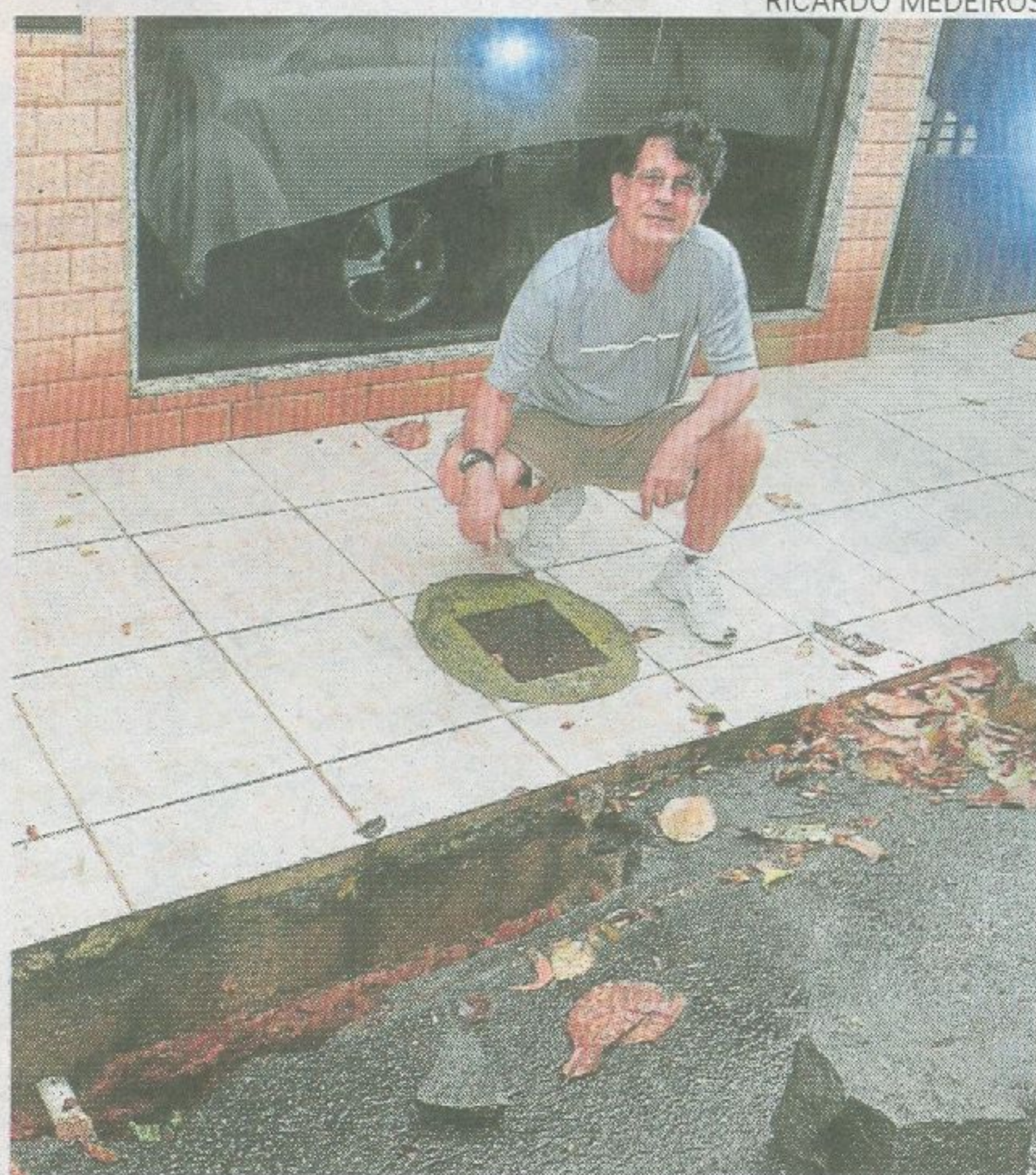
A casa de Edilson Layber fica abaixo do nível da rua
