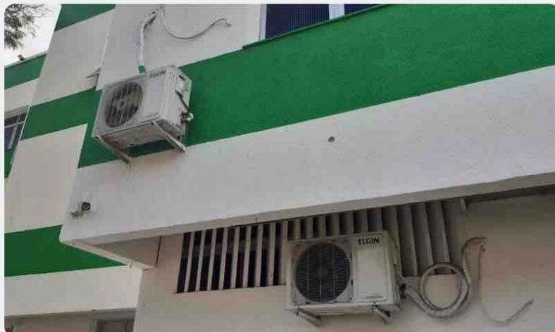
Disparos danificaram a parede da fachada e também uma janela do primeiro andar do prédio | Foto: Assessoria / Ifes
